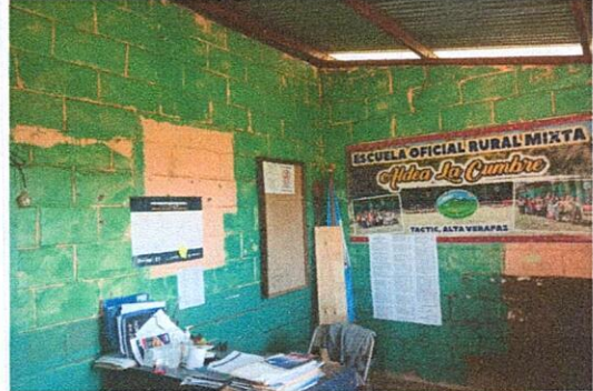
Foto 3: SUSTITUCION DE PINTURA DE LAS AULAS POR DETERIORO
