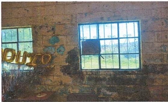
Foto 3: SUSTITUCION DE PINTURA DE LAS AULAS POR DETERIORO
